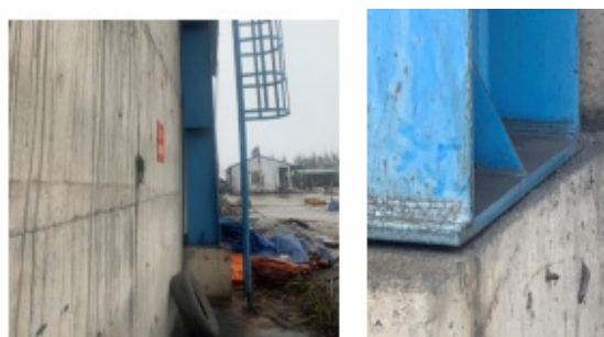
Hình 5. Hiện trạng hư hỏng tường chắn, cột nhà kho than bằng bê tông cốt thép.
