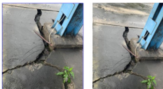
Hình 3. Hiện trạng hư hỏng và biến dạng của kết cấu băng tải và trạm chuyển tải.
