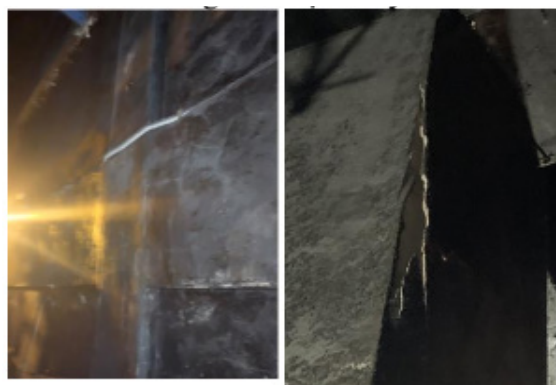
Hình 4. Hiện trạng hư hỏng của bunke cấp liệu tại kết cấu tường, cột và dầm.
